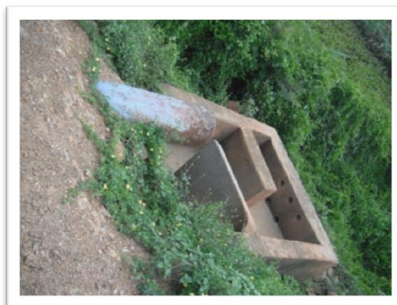
Imagen 5. Salida del agua residual mediante el bombeo
