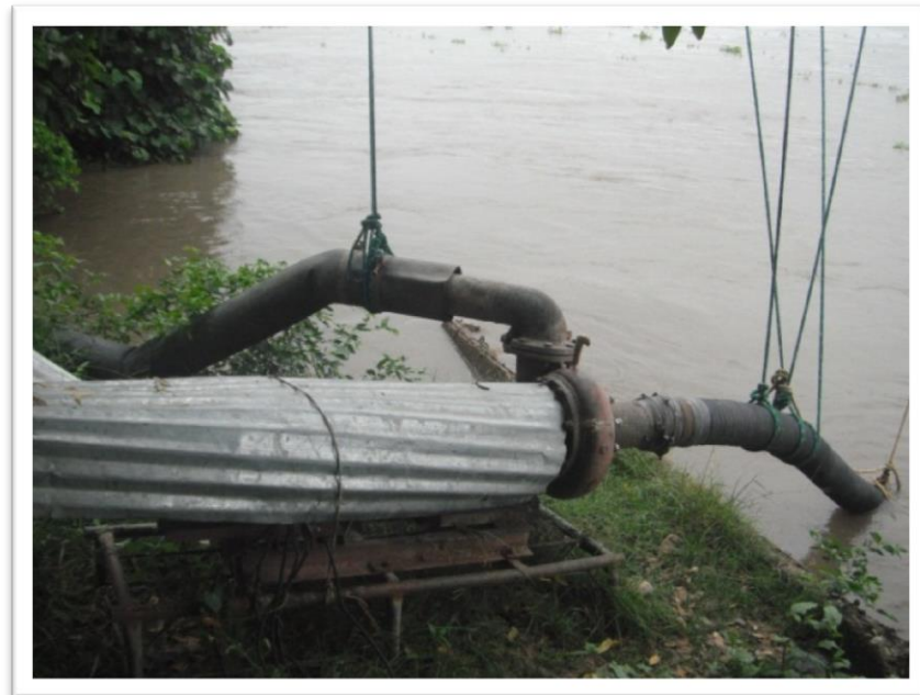
Imagen 11 captación del agua desde el rio magdalena para su tratamiento
