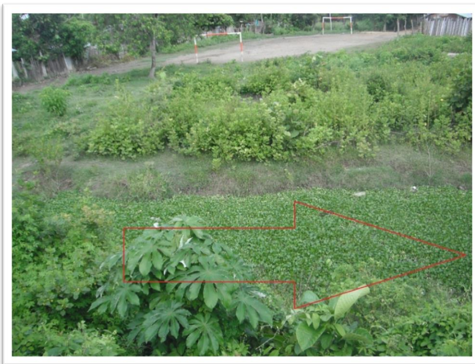
Imagen 2. Zanja llena de aguas residuales donde por falta de limpieza es muy visible el crecimiento de plantas.
