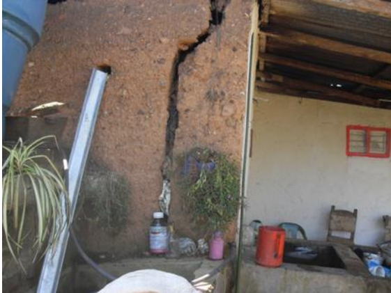
Vivienda afectada en barrio 25 de noviembre
