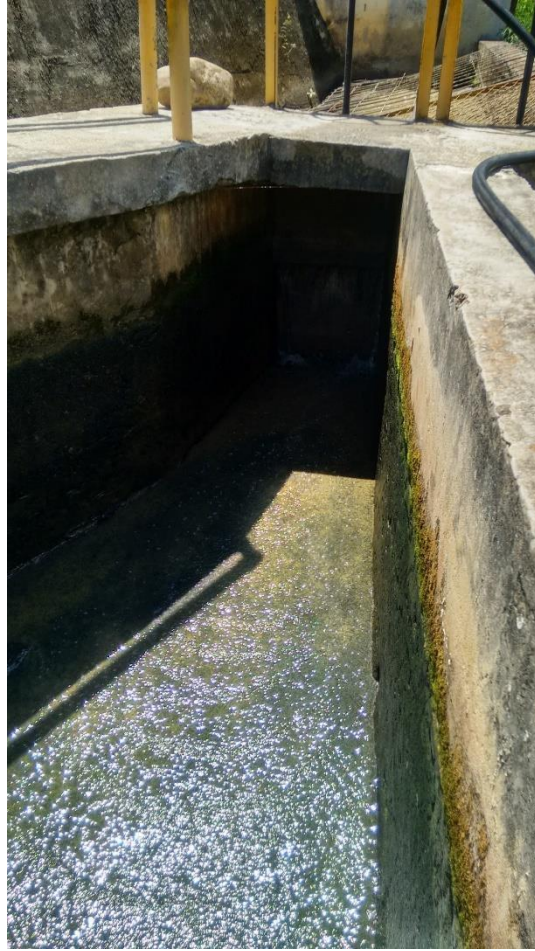
Panorámica 2 Compuertas que comunican el canal de aducción con los desarenadores, ESPO S.A.
