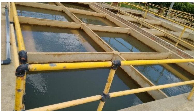
Figura 34. Panorámica 1 Flocuradores PTAP El Algodonal.
