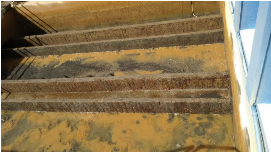
Panorámica 2 filtros sucios, ESPO S.A.
