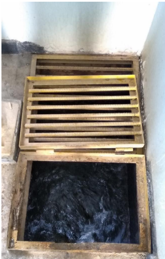
Figura 26. Panorámica 1 Cámara de quietamiento PTAP El Algodonal.
