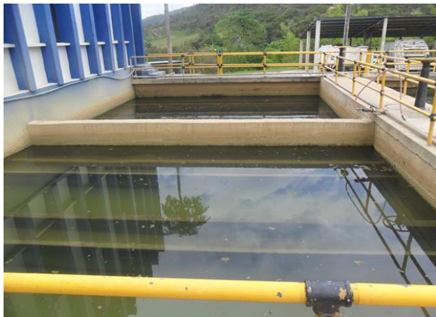
Figura 38. Panorámica 1 filtros PTAP El Algodonal.
