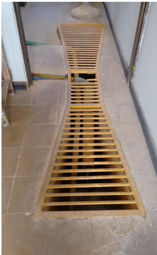
Figura 29. Panorámica 2 Canaleta Parshall PTAP El Algodonal.
