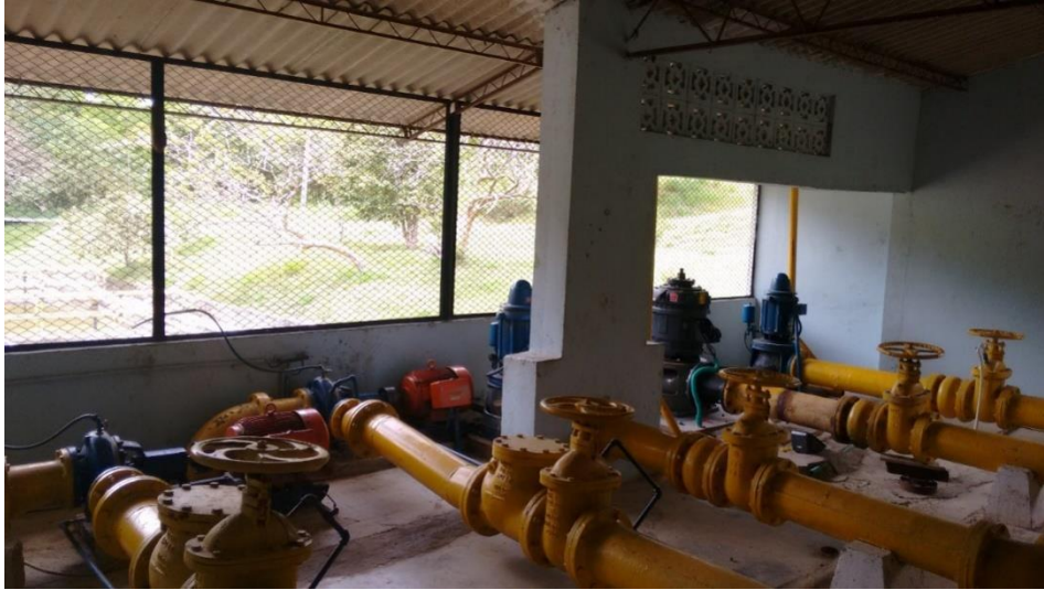
Panorámica 4 Motobombas y tubería ubicada en la estación de baja cabeza, ESPO S.A.
