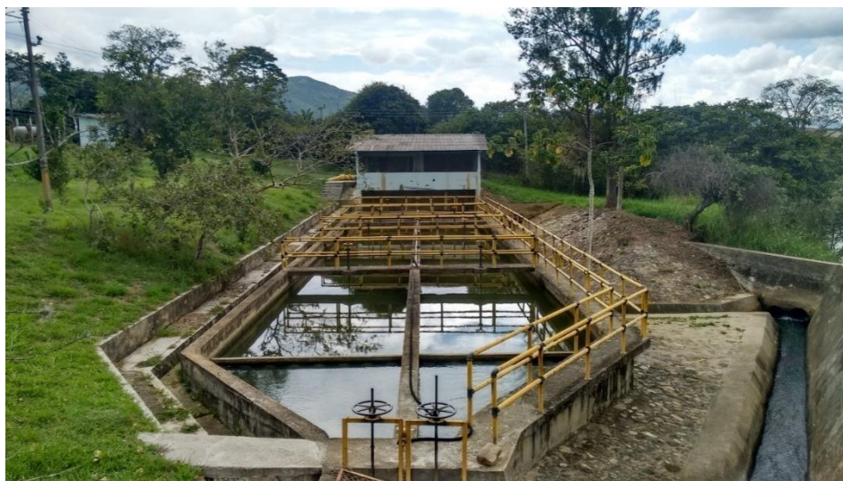
Figura 21. Panorámica 1 Desarenador PTAP El Algodonal.
