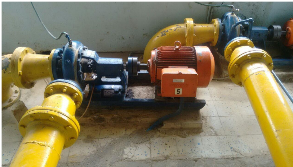
Motobomba ubicada en la planta de baja cabeza, ESPO S.A.
