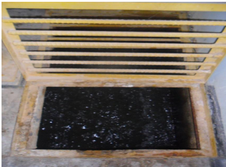
Figura 27. Panorámica 2 Cámara de quietamiento PTAP El Algodonal.
