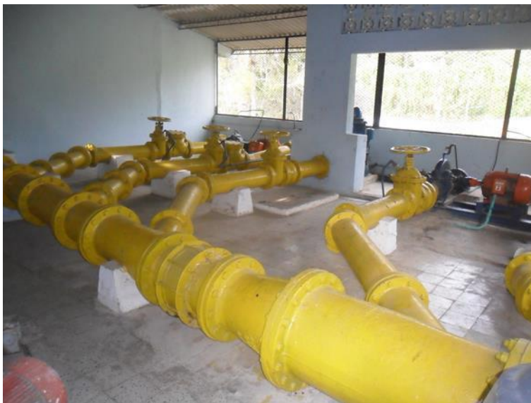
Figura 25. Panorámica 3 Estación de Bombeo PTAP El Algodonal.
