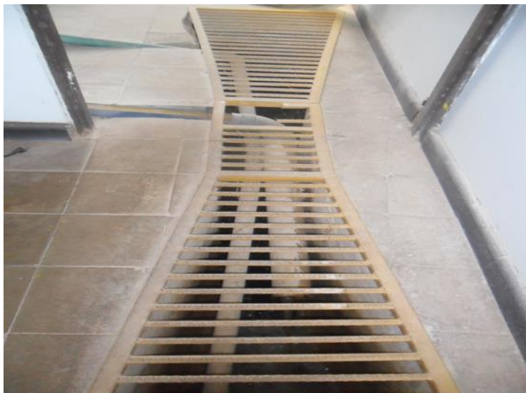
Figura 30. Panorámica 3 Canaleta Parshall PTAP El Algodonal.
