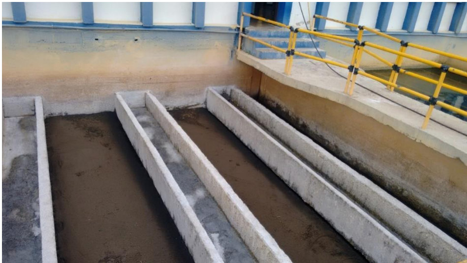
Panorámica 6 filtro limpio, ESPO S.A.
