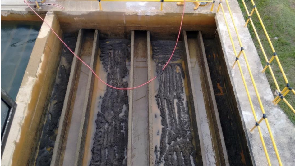
Panorámica 3 filtros en mantenimiento, ESPO S.A.
