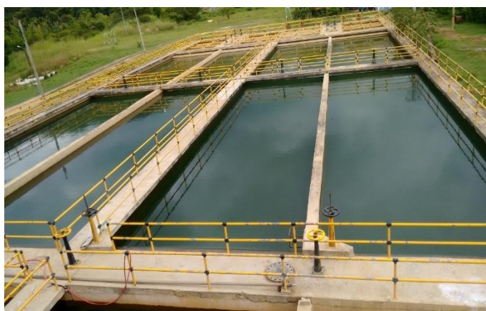
Figura 37. Panorámica 2 sedimentadores PTAP El Algodonal.
