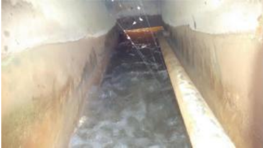
Canal de aproximación
