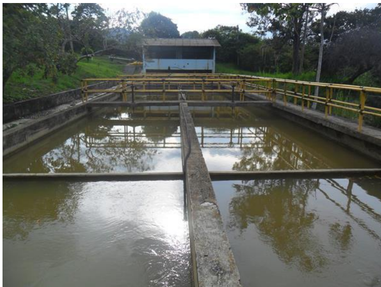
Figura 22. Panorámica 2 Desarenador PTAP El Algodonal.
