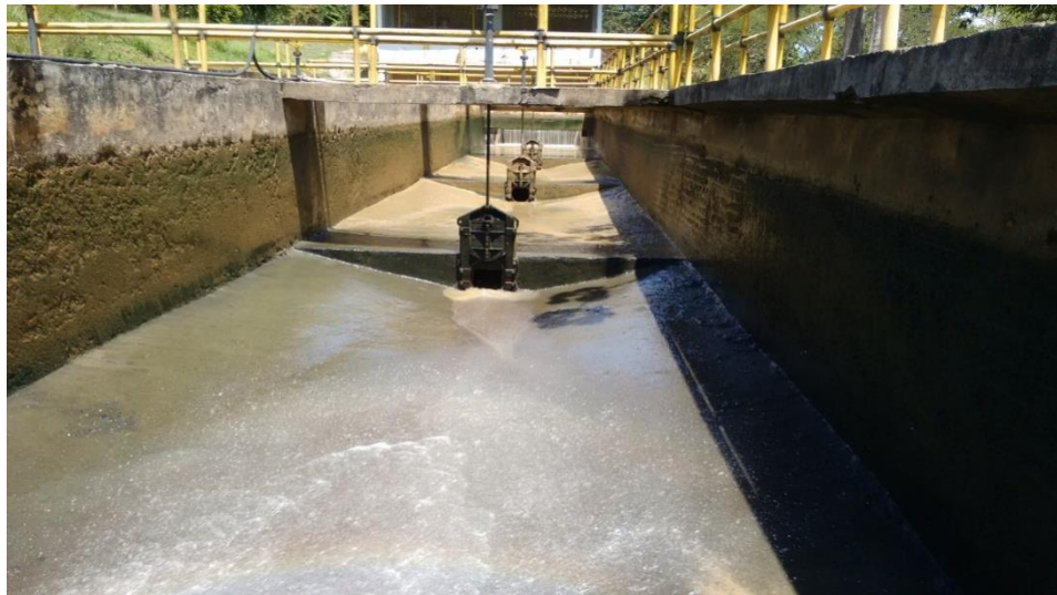
Panorámica 10 Tanques listos para empezar a operar, ESPO S.A.
