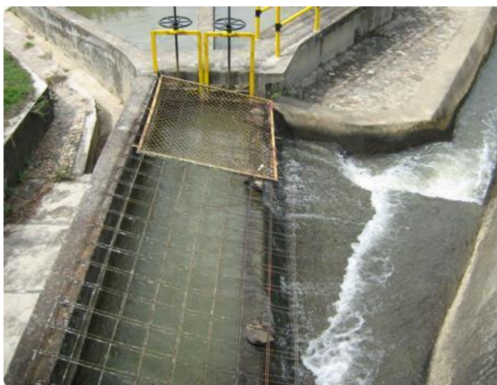
Figura 3. Canal de aducción con vertedero lateral – Planta de Tratamiento El Algodonal.
