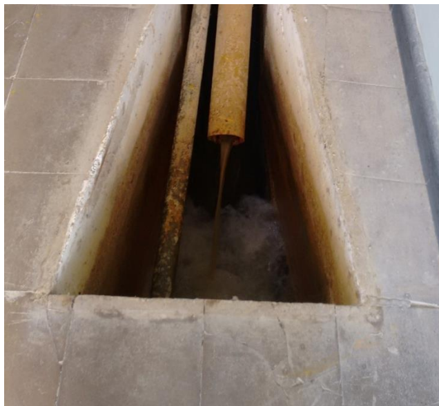
Figura 31. Panorámica 1 proceso coagulación (mezcla rápida) PTAP El Algodonal.
