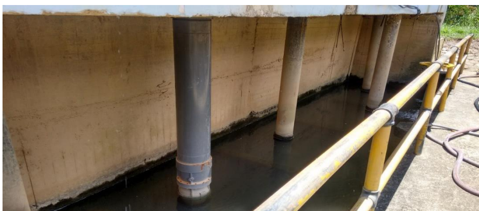
Figura 24. Panorámica 2 Estación de Bombeo PTAP El Algodonal.
