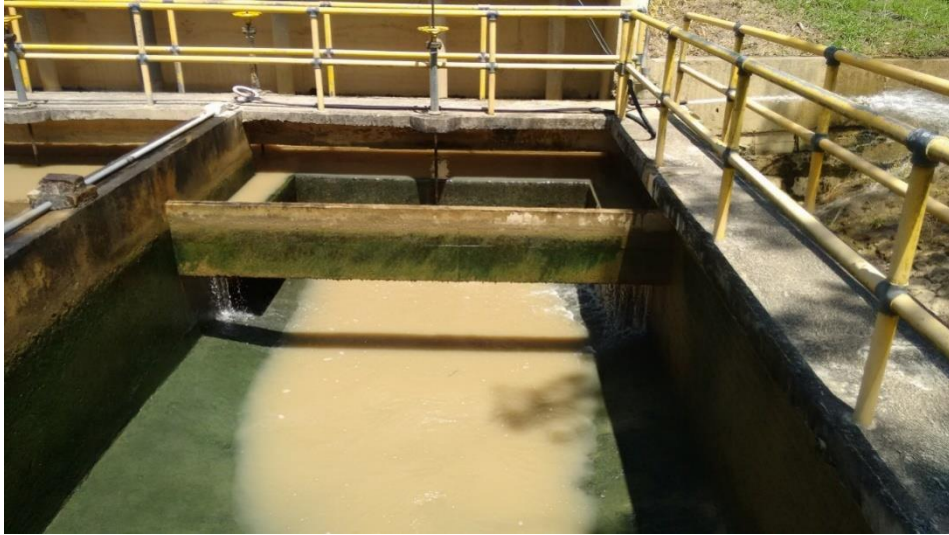
Panorámica 13 Tanque empezando a operar, ESPO S.A.
