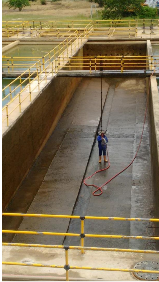
Panorámica 10 Sedimentador lavado, ESPO S.A.
