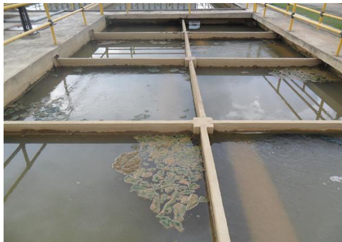
Figura 35. Panorámica 2 estructura de floculadores PTAP-El Algodonal.
