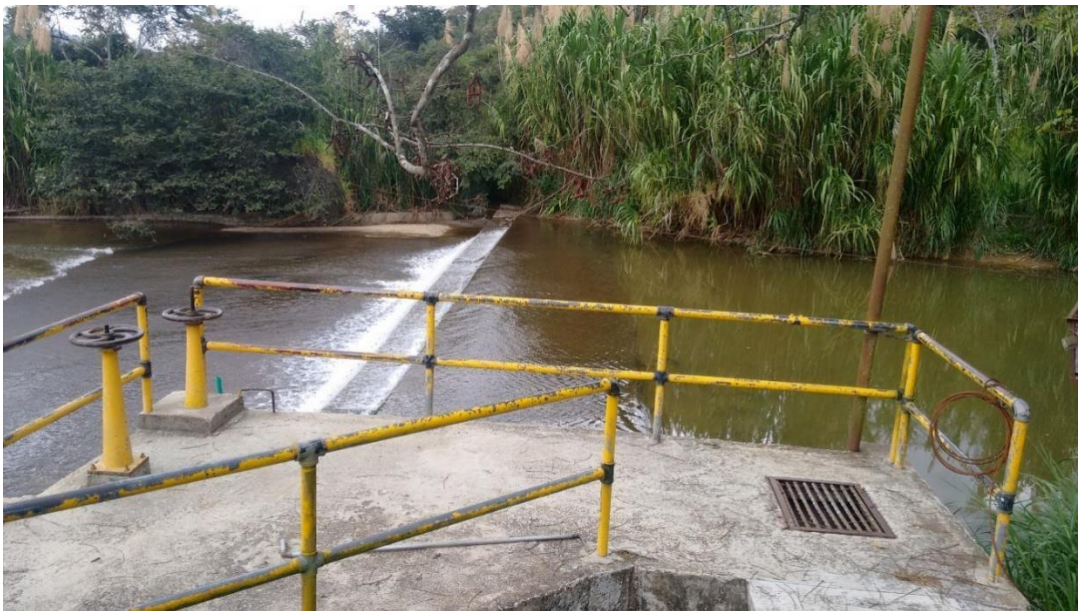
Figura 18. Canal de derivación PTAP- El Algodonal.
