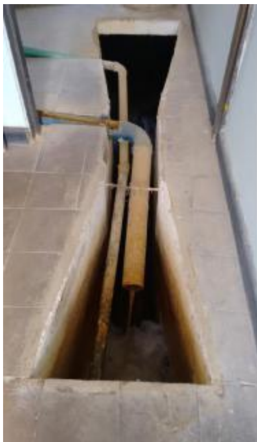
Figura 28. Panorámica 1 Canaleta Parshall PTAP El Algodonal.
