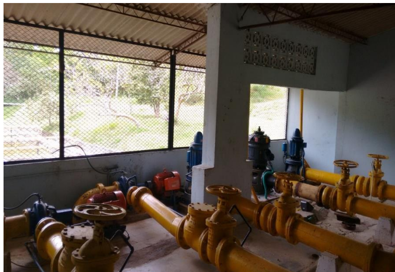
Figura 23. Panorámica 1 Estación de Bombeo PTAP El Algodonal.
