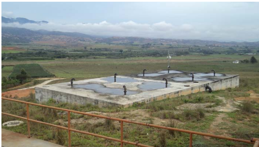
Foto 3. Tanque de agua tratada (Unidad de Servicios Públicos del municipio de Abrego).
