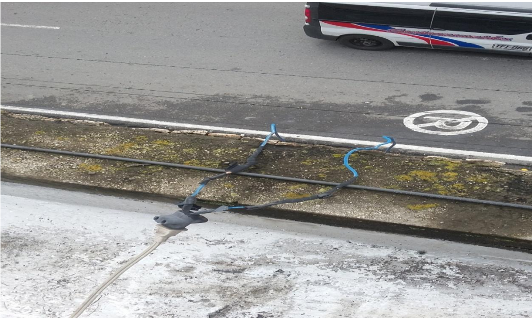
Figura 11. Sumistro de electricidad a todo el sistema de red de datos
