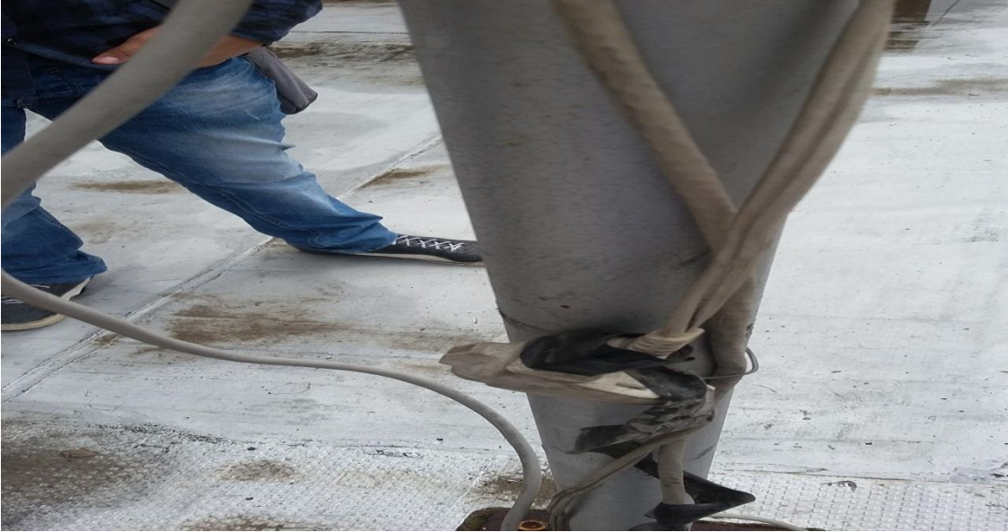
Figura 6. Punto se suministro de electricidad al primer dispositivo Access point
