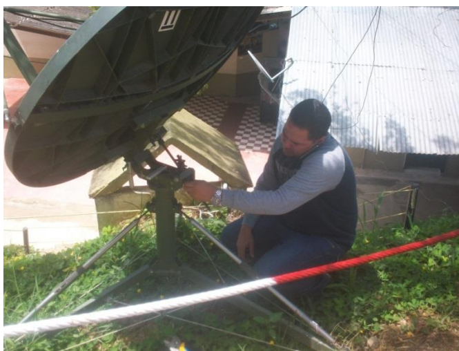
Figura 7. Apuntamiento antenas satelitales.
