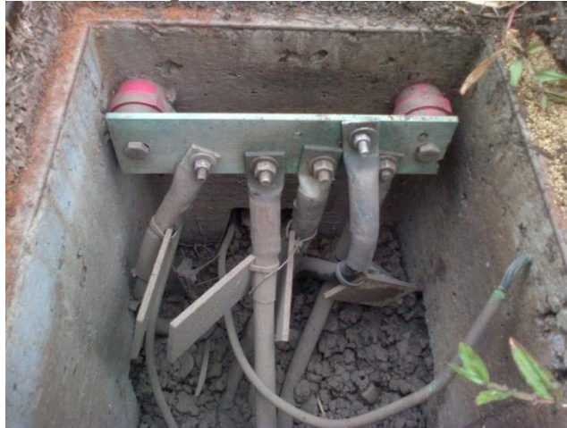
Figura 8. Inspección sistemas de puesta a tierra.
