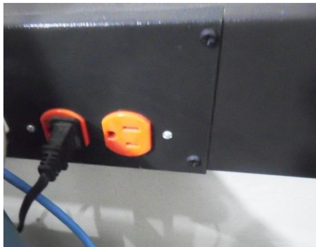
Figura 25. Canaleta metálica sin UPS
