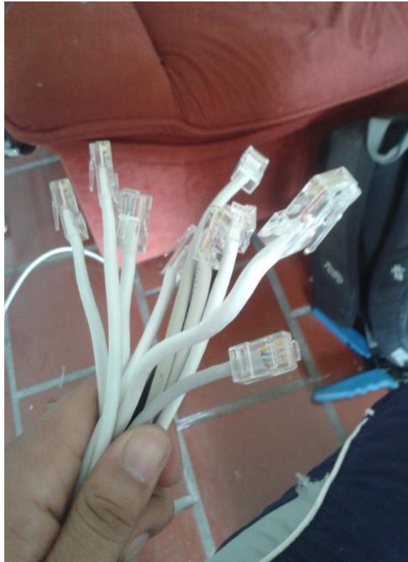
Punchado de los conectores RJ 45 en el cable UTP categ 5e utilizando la norma clase b
