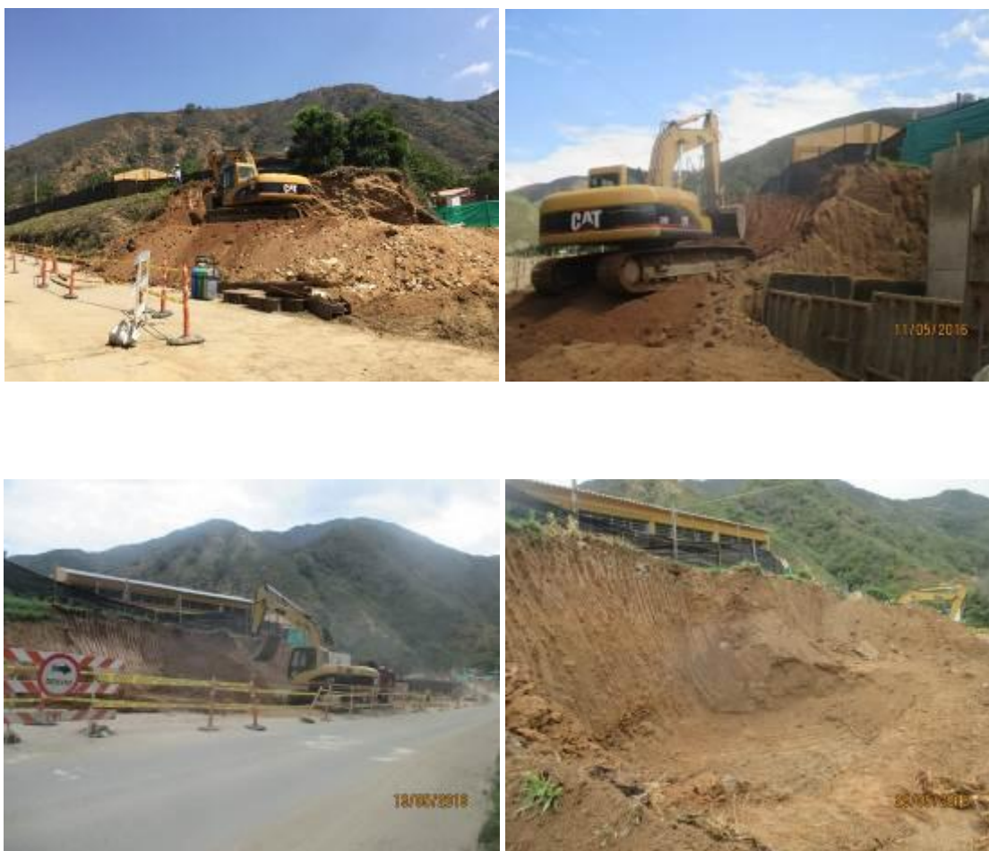
Fotografía 52. Excavación realizada para la Construcción muro en Concreto Reforzado Escuela El Tarrita
