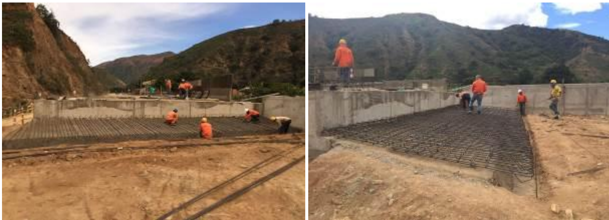
Fotografía 47. Armado Acero de Refuerzo Losas de Aproximación a la salida del puente
