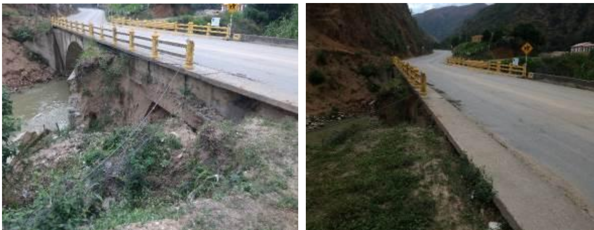
Fotografía 1. Estado inicial Puente El Tarra - Socavación apoyo estribo occidental
