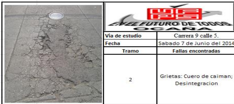
Imagen 16. Fallas encontradas en la Carrera 9 calle 5.
