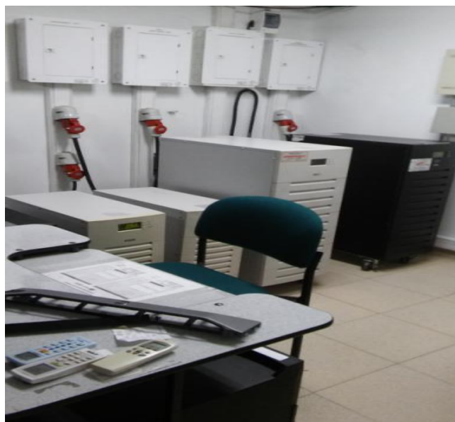
Ilustración 11. Instalación eléctrica dentro del Centro de Cómputo.
