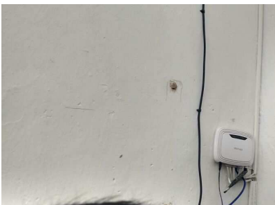
Figura 21. Router del ISP. Fuente. Autor del proyecto
