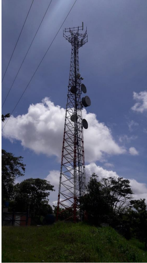
Figura 12. Vista de la torre de telecomunicaciones de Pueblo Nuevo.
