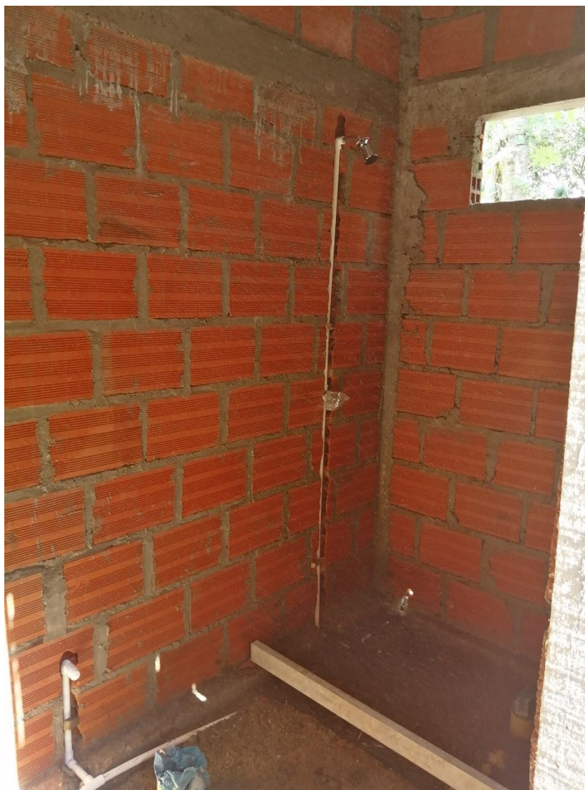
Figura 14. Instalaciones hidráulicas para ducha
