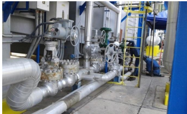
Figura 32. Válvulas Agua de Alimentación
