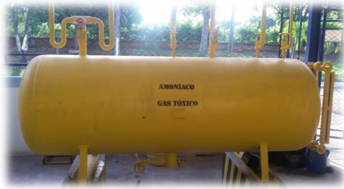
Figura 23. Tanque receptor de almacenamiento.
