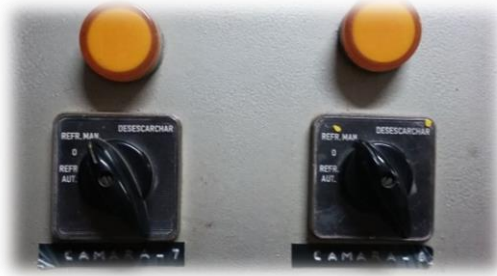
Figura 28. Mando inicio/parada, desescarche cámara 6
