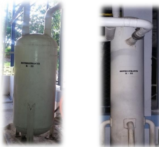
Figura 50. Tanques de almacenamiento de freón
