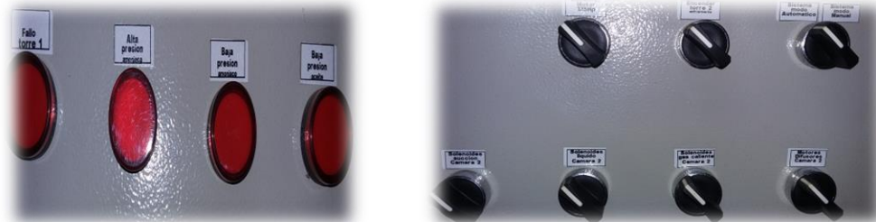
Figura 33. Perillas de modo automático/manual
