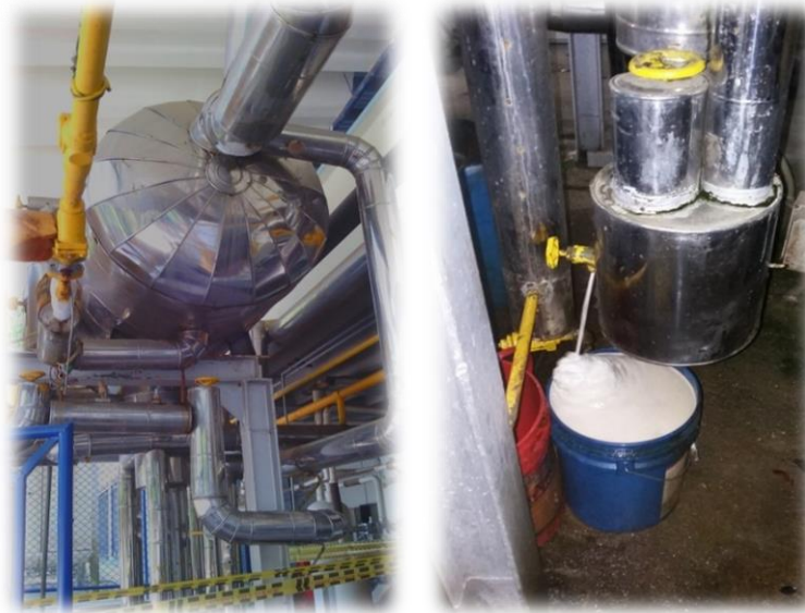
Figura 17. Tanque separador y purga de aceite del colector.
