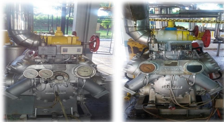
Figura 10. Compresor alternativo SABROE SMC 10/100 y 6/100 (vista frontal)
