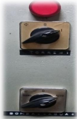
Figura 27. Mando inicio/parada de torre de enfriamiento
