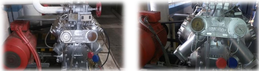
Figura 45. Compresor alternativo SABROE SMC 6/100 y 4/100 (vista frontal)
