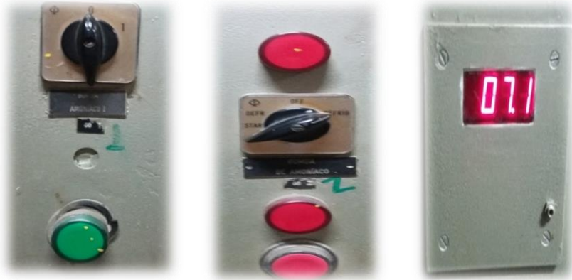
Figura 26. Mando inicio/parada de bombas de amoniaco.
