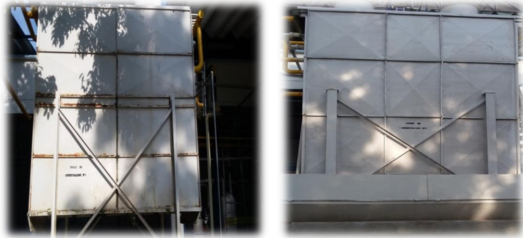
Figura 21. Torres de enfriamiento 1 y 2.
