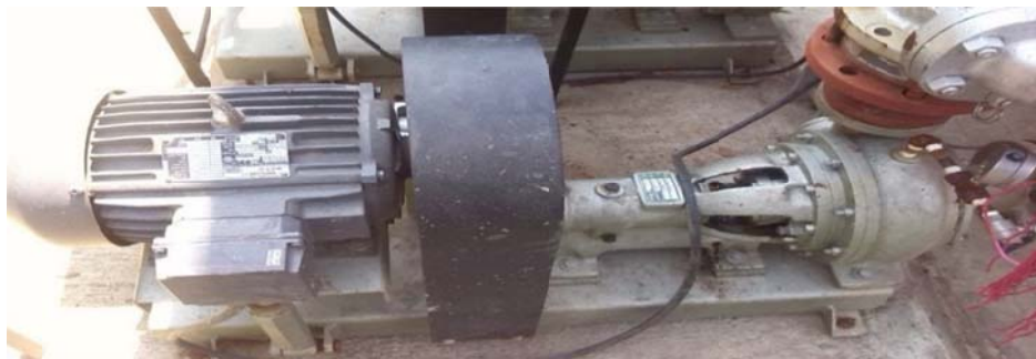
Fotografía 16. Motor y bomba de lodos florentinos.
