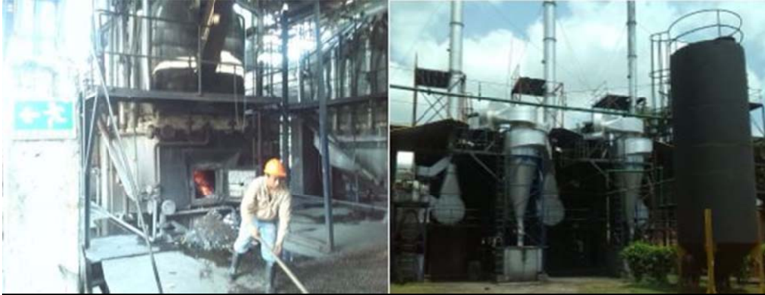
Fotografía 12. Sección generación de vapor.
