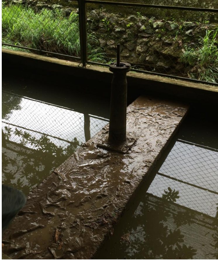
Anexo 2. Válvula central en mal estado para la purga del desarenador vereda El Gitano.
