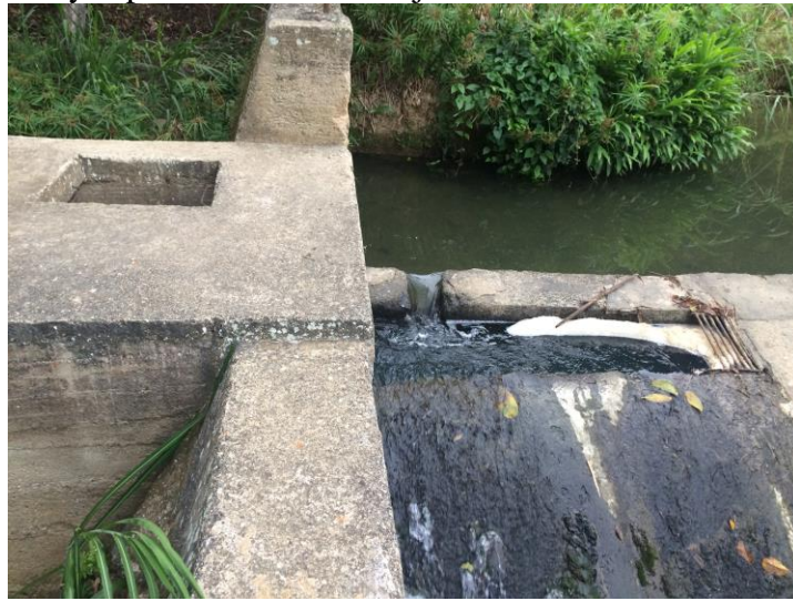
Imagen 2. Bocatoma y captación lateral sin rejillas.
