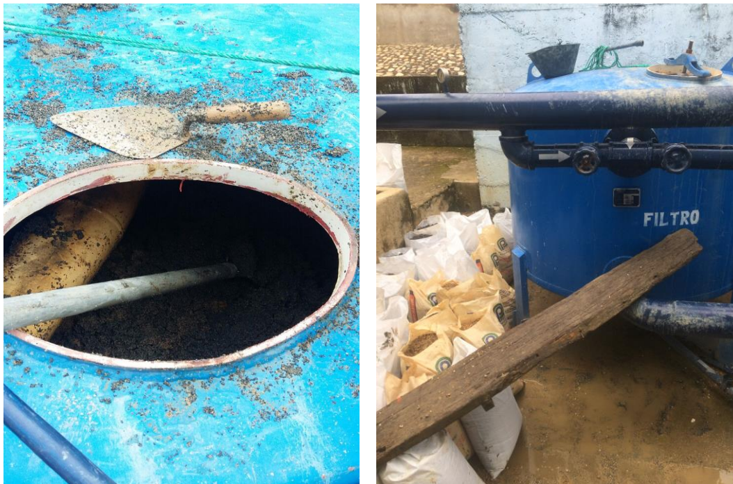
Imagen 11. Inspección al interior de filtros. Material removido desde el interior de filtros.
