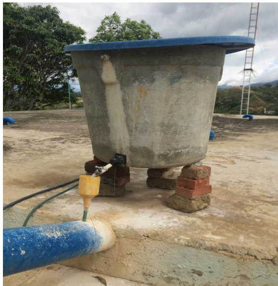
Imagen 13. Suministro de hipoclorito de calcio granulado al sistema de almacenamiento.
