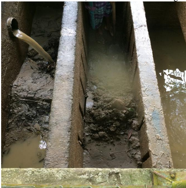
Imagen 4. Mantenimiento del desarenador, material de arrastre de gran tamaño.
