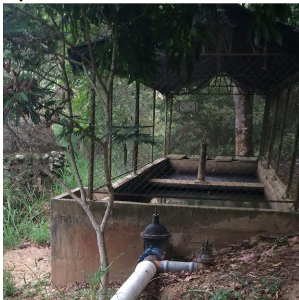
Imagen 3. Desarenador y válvulas de acceso.
