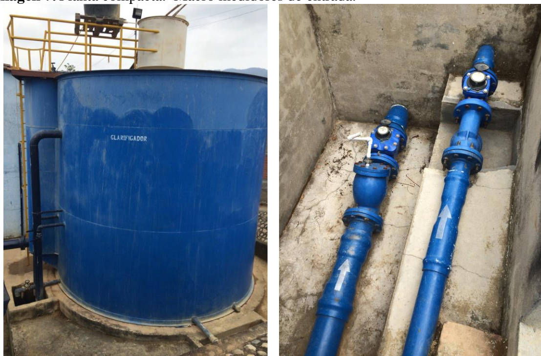
Imagen 7. Planta compacta. Macro medidores de entrada.
