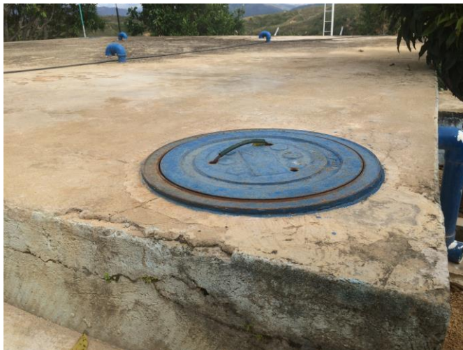
Imagen 14. Tanque de almacenamiento No.1, rebose y sistema de circulación de aire.
