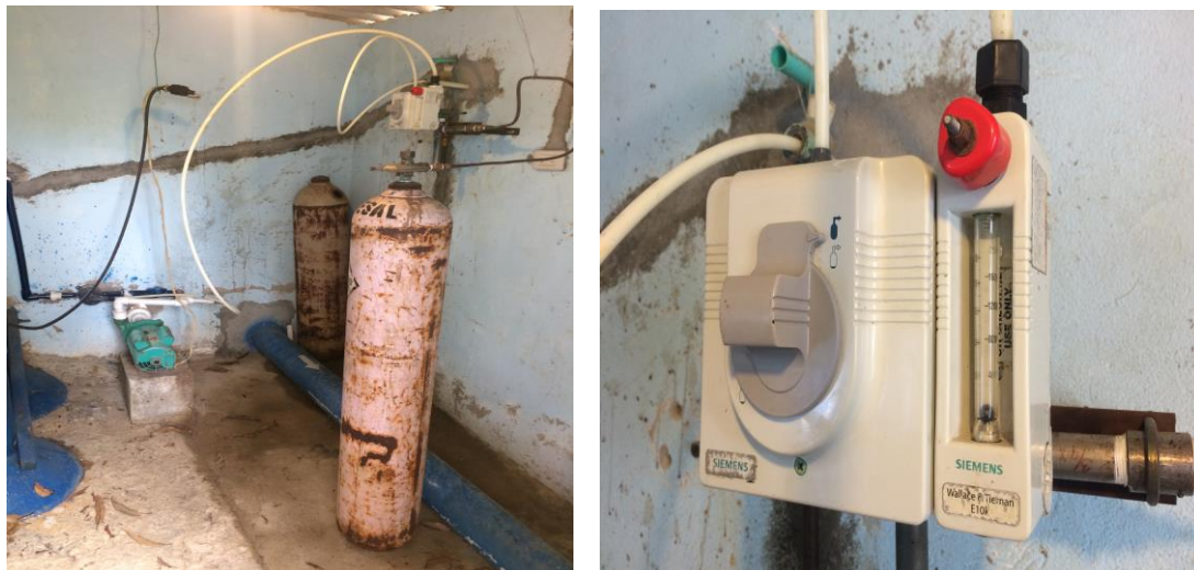
Imagen 12. Sistema de cloración. Vista detallada del clorador.
