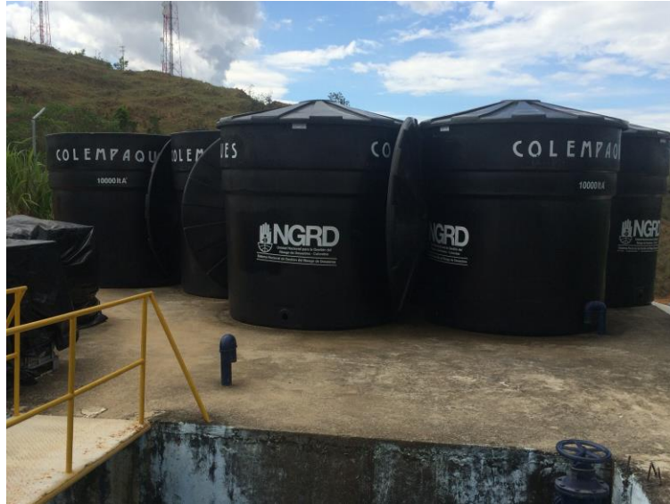
Anexo 9. Tanques de almacenamiento donados por CORPOCESAR.
