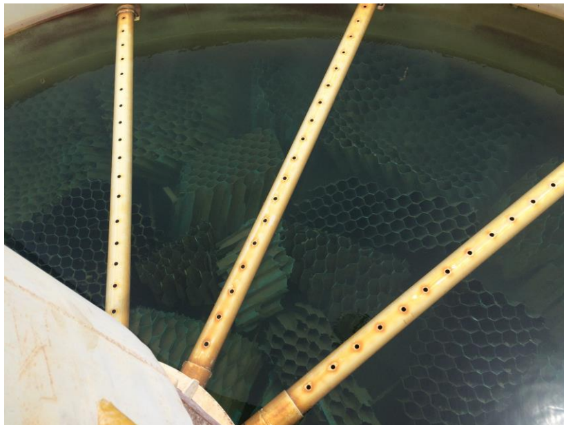
Imagen 8. Parte superior del sistema de clarificación. Tubería en forma de flauta y vista de sedimentadores en mal estado.
