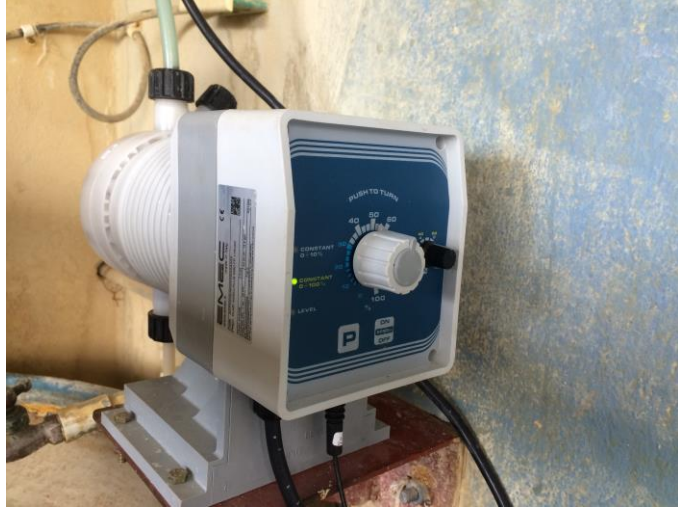
Anexo 11. Dosificador de Sulfato de Aluminio. Coagulante anterior y nuevo coagulante seleccionado.
