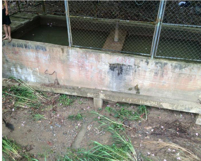
Anexo 1. Material arrastrado por las precipitaciones en la caja de puga del desarenador.
