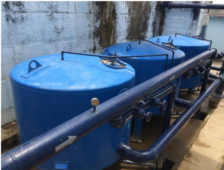
Imagen 10. Unidades de filtración.
