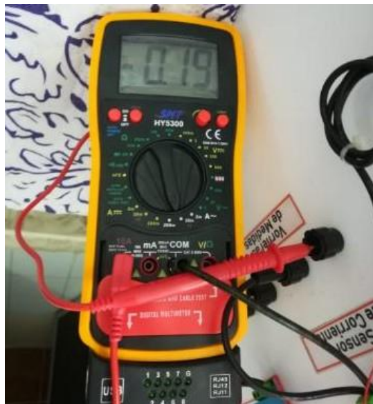
Figura 84. Toma de corriente en multímetro con las lámparas encendidas Fuente. Autor del proyecto
