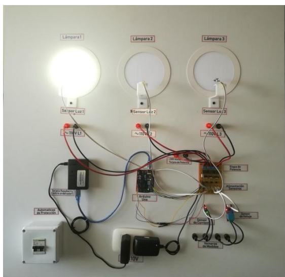
Figura 70. Lámpara 1 encendida en el tablero Fuente. Autor del proyecto
