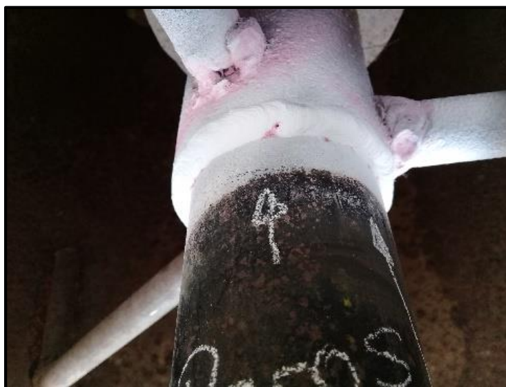
Figura 37. Reparación de cordón de soldadura en el quemador de la Tea, revelado por la prueba de líquidos penetrantes.
