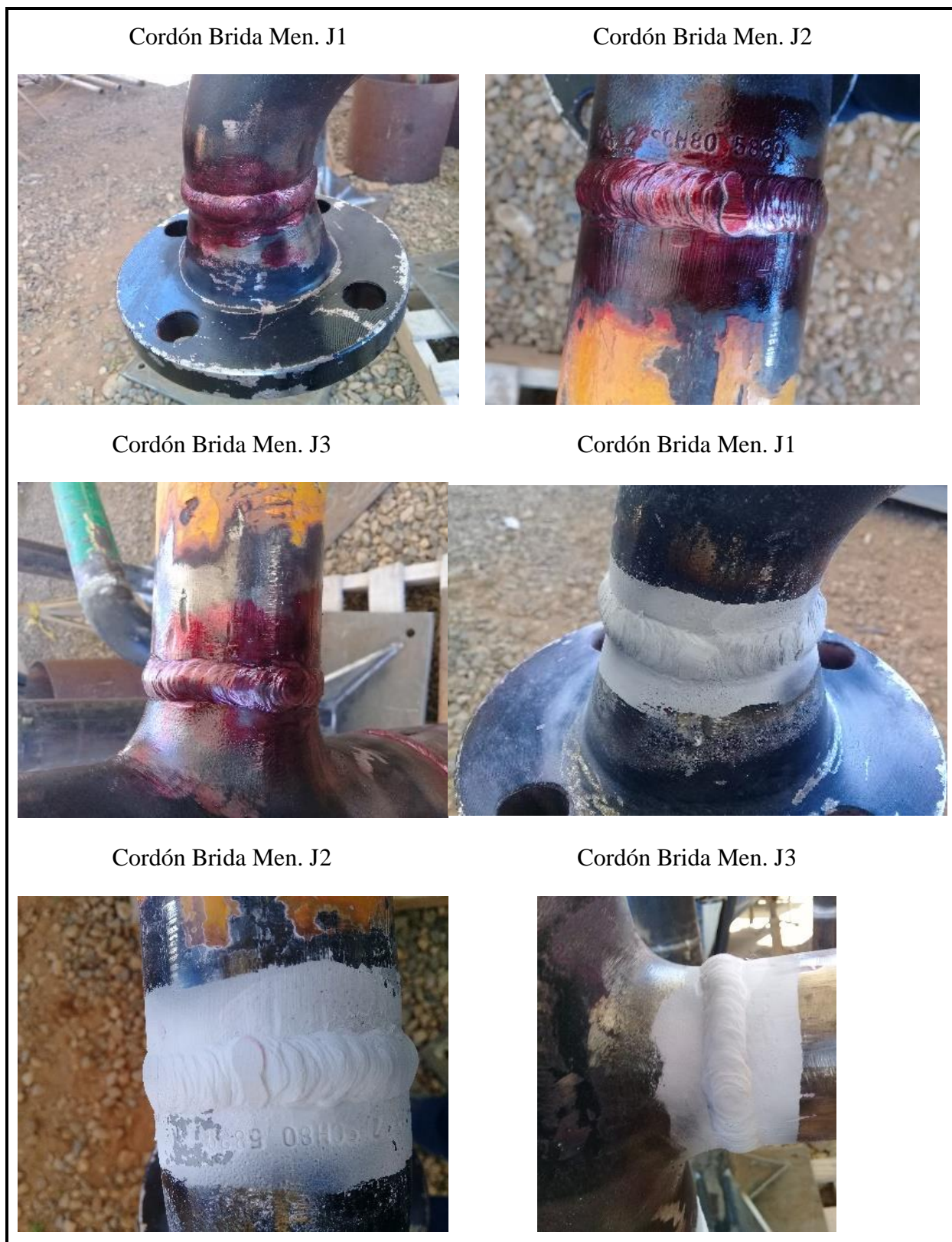
Figura 31. Prueba de líquidos penetrantes a cordón brida de la ménsula.
