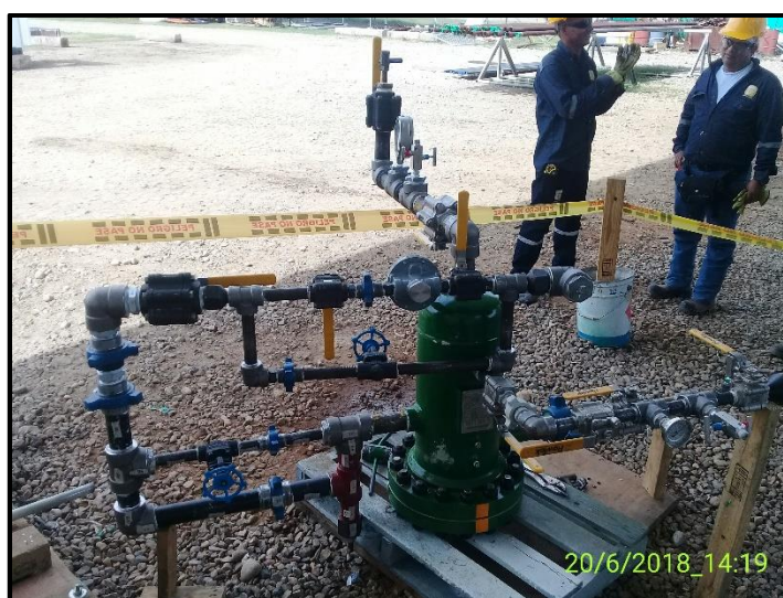
Figura 50. Cabezal de pozo modificado, incluye Bypass.
