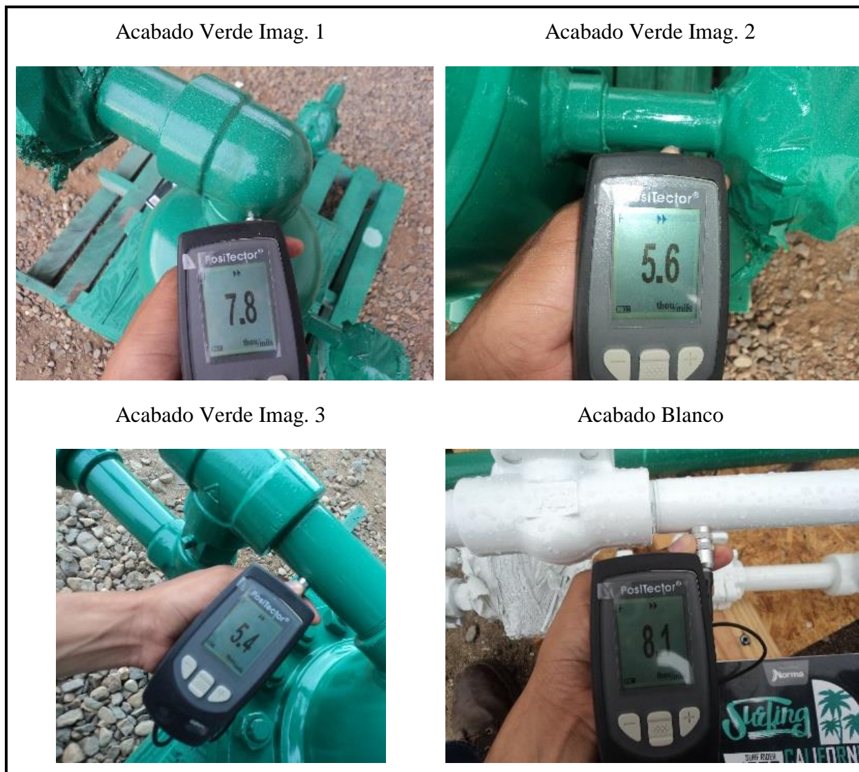
Figura 44. Espesor de pintura a los Spool del cabezal de pozo. (Pintura de acabado: verde y blanco)
